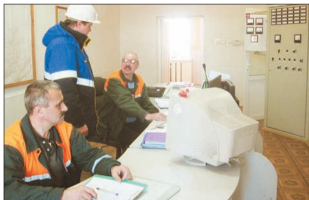
Главный щит управления станции. Слева направо: электромонтер по обслуживанию электрооборудования М.П. Марозенок, директор филиала А.А. Худобкин, начальник смены электростанции А.Я. Бондарс
